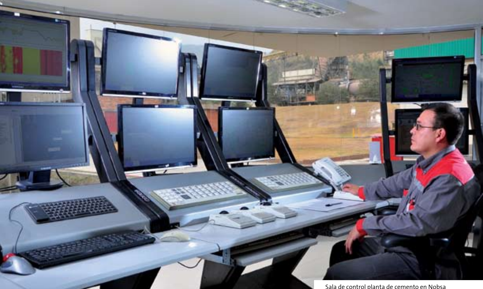
Sala de control planta de cemento en Nobsa
